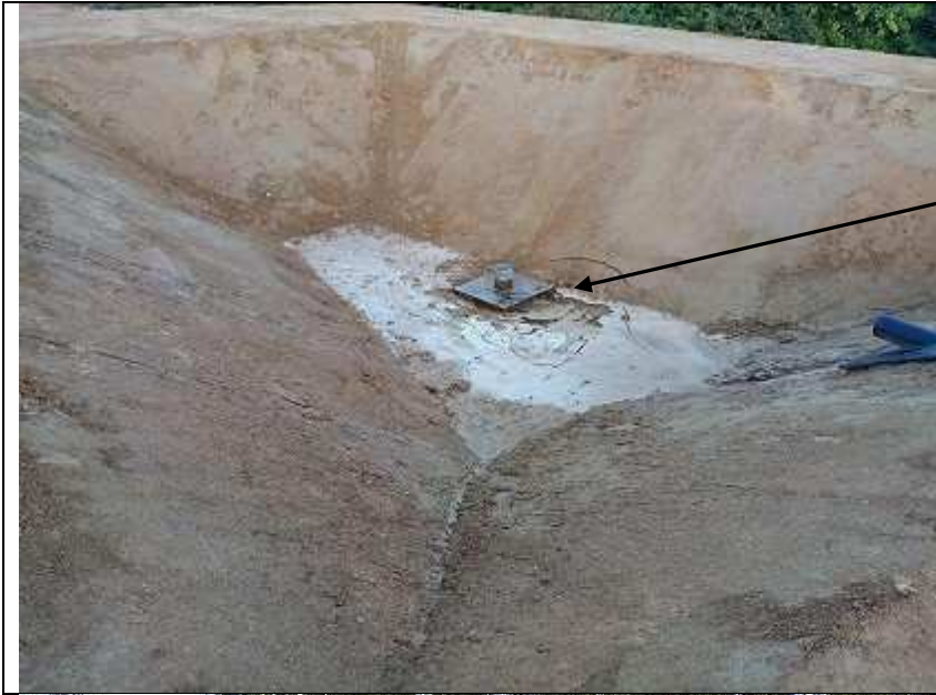
Photo suite événement pluvieux
