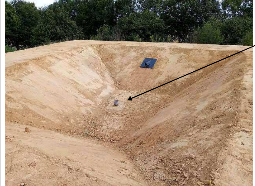
Photo de reprise de tassement
